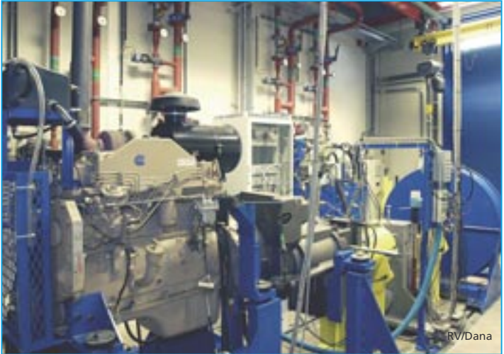
Des stands d'essai spécifiques sont utilisés pour chaque test. En photo: une infrastructure pour les essais Watt.
